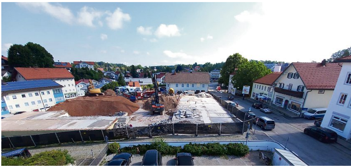
So ist der aktuelle Stand: Die alten Postgebäude sind entfernt und der Bauschutt getrennt und aufgearbeitet. Nun folgt noch der Abriss des früheren Schmederer- und Niederberger-Hauses. Dann stehen rund 4000 Quadratmeter Grundstücksfläche zur Verfügung.
